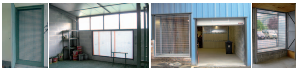
L'entrée est équipée d'un filtre pour éviter la pollution des pièces peintes.
