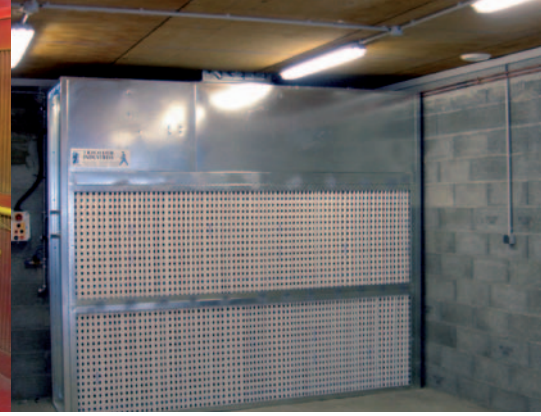
Cabine ALTO 2 ou bloc aspirant, service technique d'une mairie.
